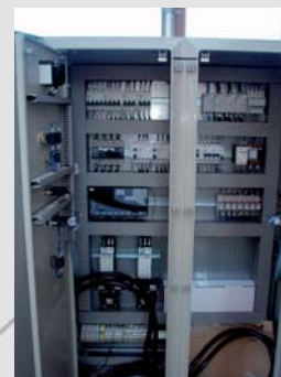
Quadre de telecontrol de bombes d'aigua.
